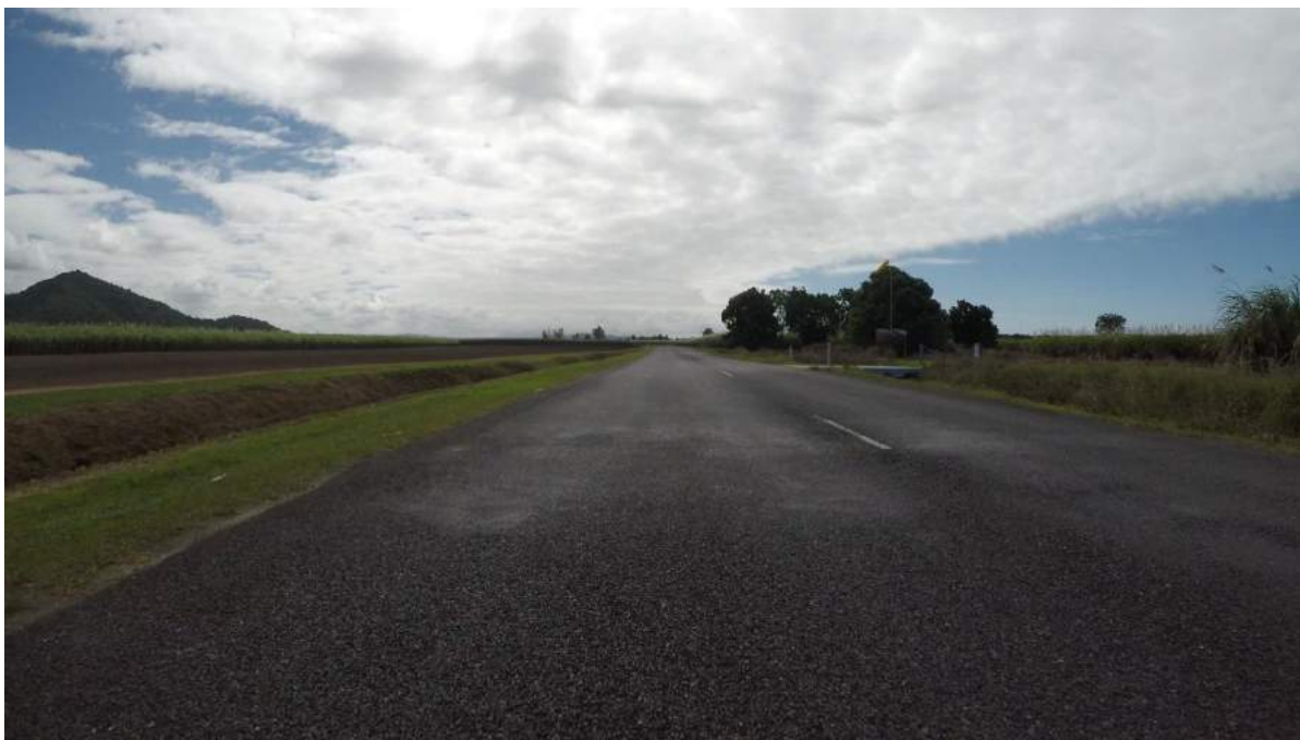
Longitudinal Rutting at 3700m
