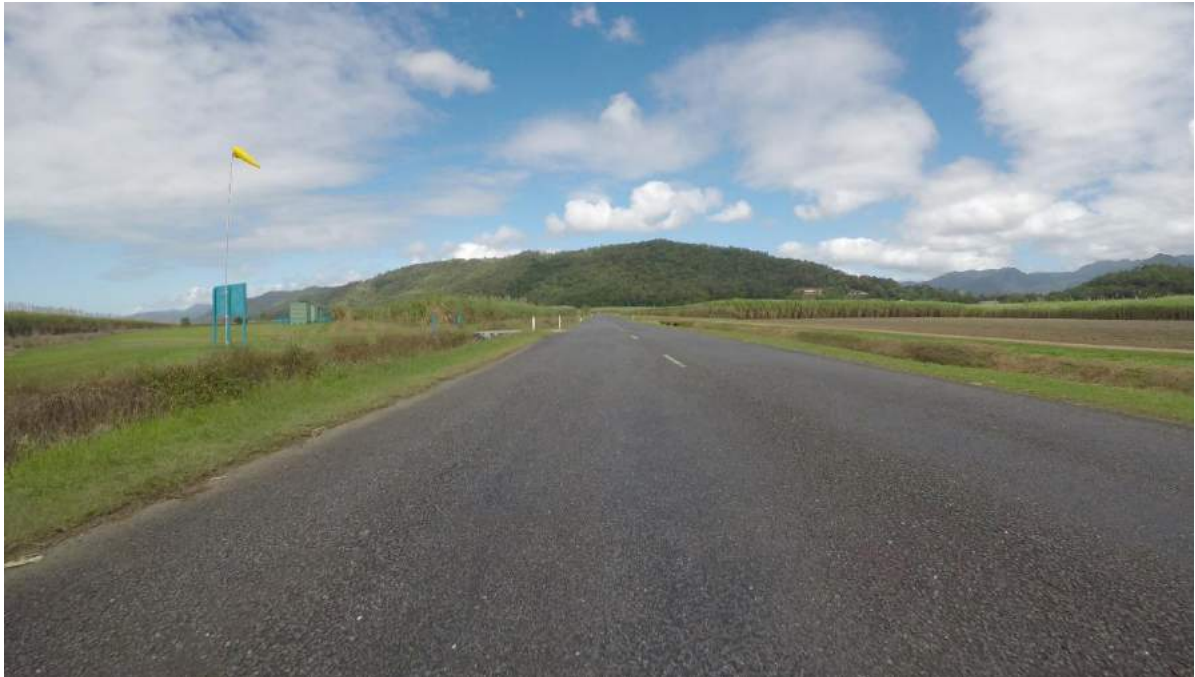
Longitudinal Rutting at 100-200m
