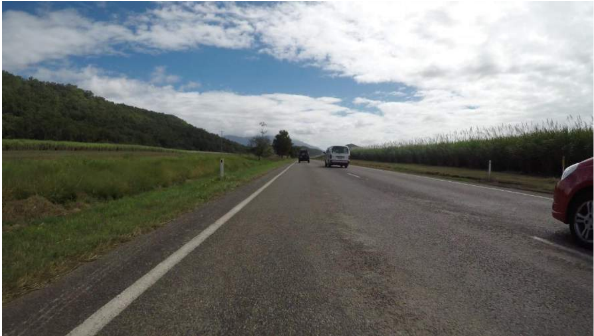
Longitudinal Rutting at 1500m
