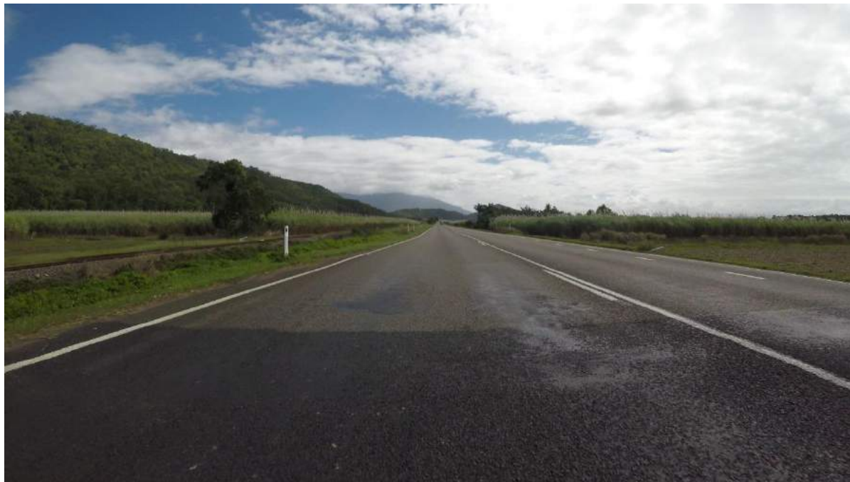
Longitudinal Rutting at 900m
