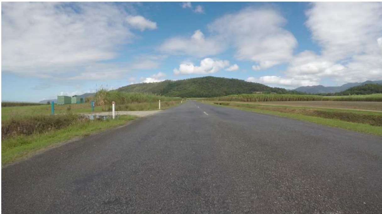
Longitudinal Rutting at 100-200m
